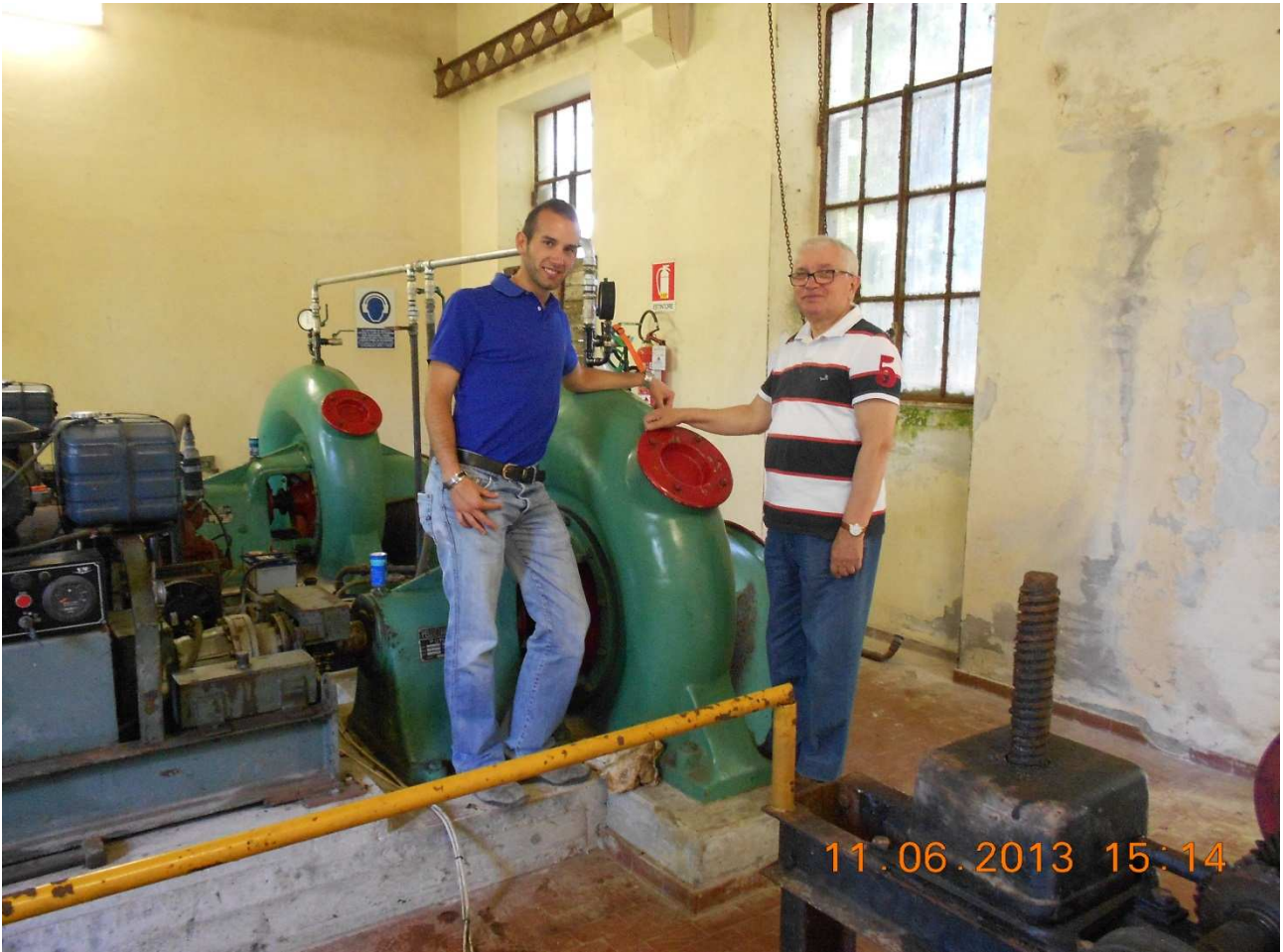
Da sinistra: il Dr. Daniele Priarone , Responsabile Depurazione e il Sig. Gian Piero Borsi , Amministratore Delegato AMAG SPA, all'interno del locale "Idrovore diesel" del depuratore di Alessandria, nel quartiere "Orti".
